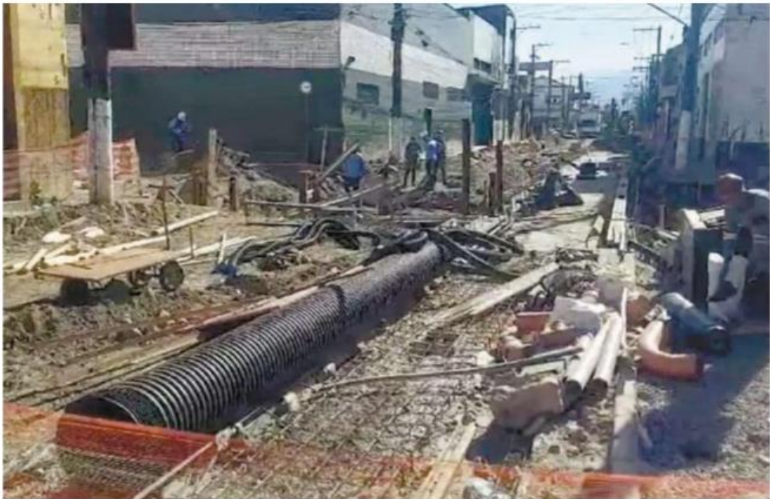
A Comgás precisou interromper o fornecimento de gás até que a ruptura o encanamento fosse reparada
